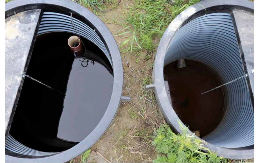
Säätökaivoista näkee selvästi, kuinka säätösalaajituksella (vasen kaivo) pystytään pohjavedenpinta pitämään korkeammalla kuin tavanomaisesti salaajitetulla alueella (oikea kaivo).
